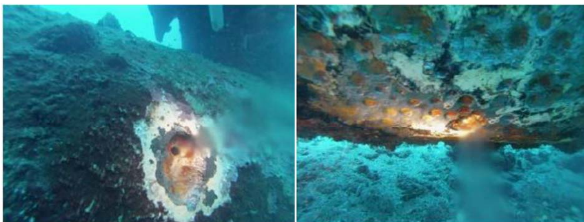
Caverne créée et percée suite à la corrosion
