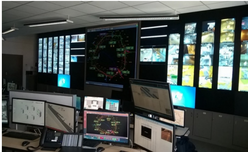
Photo n° 2 : Poste de contrôle et d'exploitation Bédier
